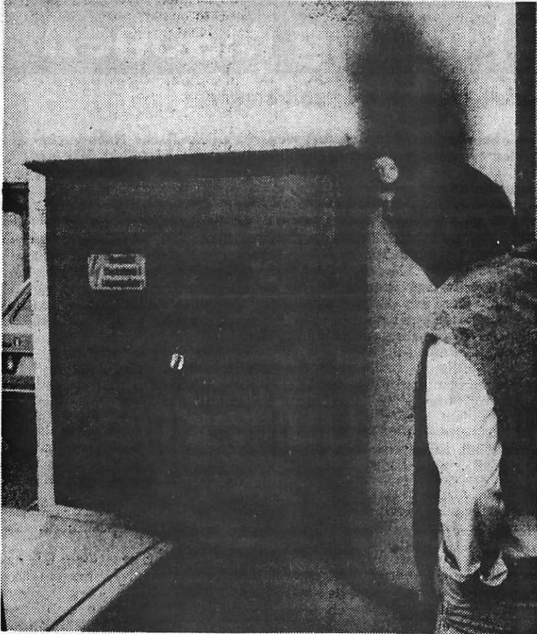
Am Schaltkasten sind noch deutlich die Spuren des Sabotageaktes vom 5. September zu sehen: ein großer schwarzer Brandfleck auf dem Putz des Mauerwerks.
