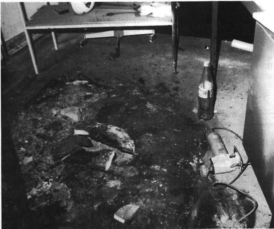
Die Räume über dem "Acht" nach dem Schwelbrand
