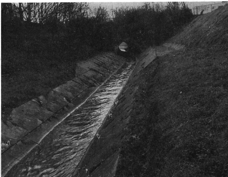
hochbelastete Fleischerei-Abwässer von Barfuß münden unter dieser Brücke in den "Köttelbach"
